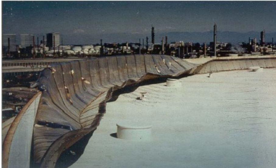
Εικόνα 21: Αστοχία Πλωτής Οροφής.
