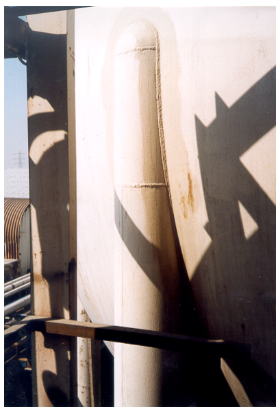
Εικόνα 17: Κατάρρευση της κατασκευής λόγω της αστοχίας της σύνδεσης κελύφους-υποστυλώματος.
