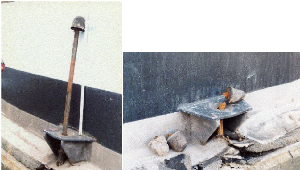
Εικόνα 16: Αστοχία στην αγκύρωση της δεξαμενής.
